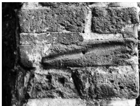
Fot. 2. Ślad podłużny na tczewskiej Farze (fot. własna)
